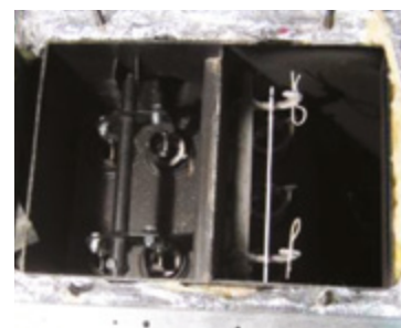
Dispositivo para la limpieza automática de los tubos para el paso de los humos.
